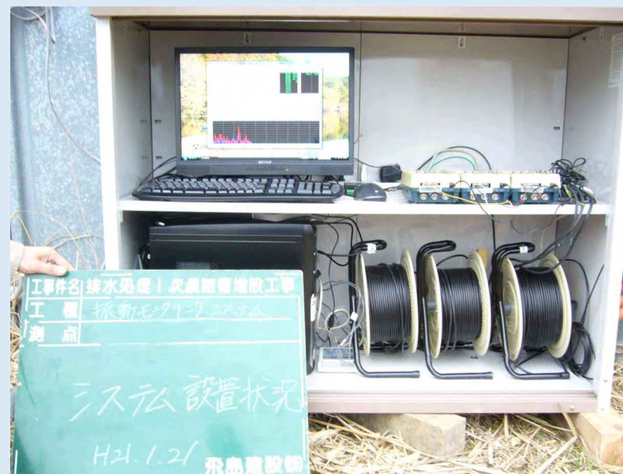
システム設置状況
